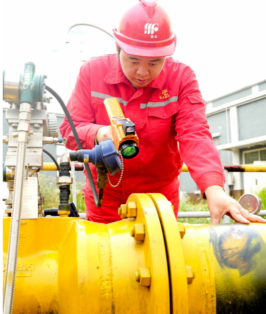
▲天投公司巡检人员对配气站进行安全检查
